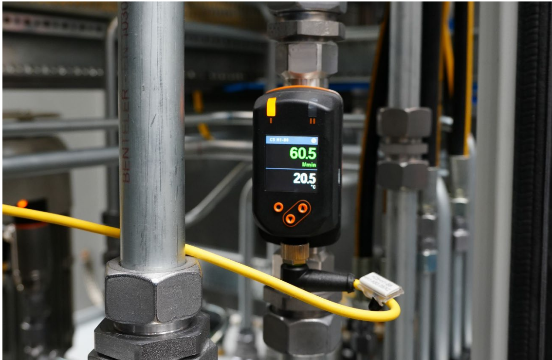
図 1：設置されていた流量と温度を測定する ifm エレクトロニクス社製センサ 出所）スターラグ社撮影。
