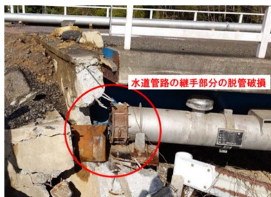
写真1 石川県 珠洲市水管橋破損
