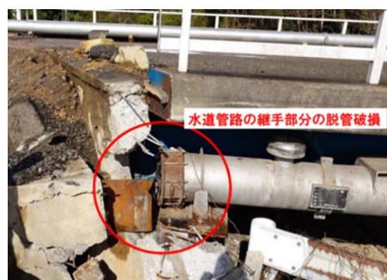
写真1 石川県 珠洲市水管橋破損
